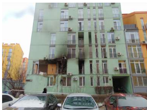
Рис. 1. Фрагмент житлового будинку (Дніпровський р-н м. Києва) після вибуху та пожежі 20.12.2022 р.
