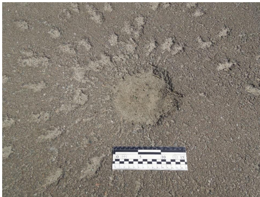
Рис. 2.10 Детальний вигляд пошкодження асфальтового покриття внаслідок влучання бойового осколкового елемента 9Н210, якими споряджуються касетні головні частини 9Н128К некерованих реактивних снарядів 9М27К калібру 220 мм
