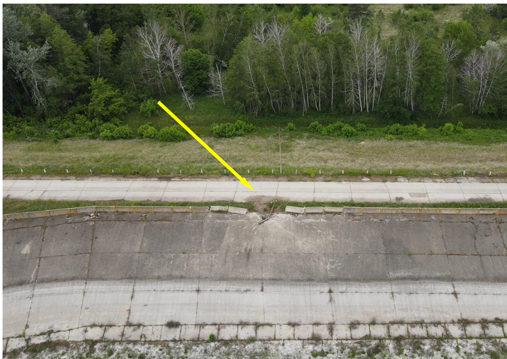
Рис. 2.16. Загальний вигляд воронки від вибуху авіаційної бомби ФАБ-250, локалізованої на дамбі; місце позначено стрілкою
