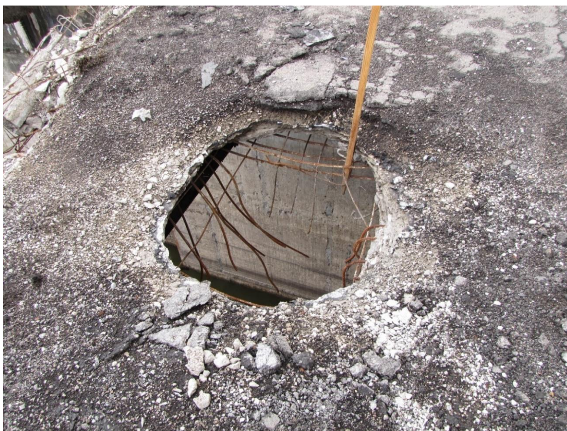
Рис. 2.15 Характер пошкоджень бетонних плит дорожнього покриття на греблі, завданих у результаті влучання авіаційної фугасної бомби ФАБ-250 (Харківська область)
