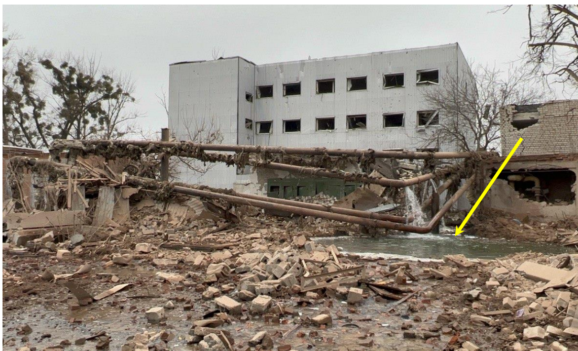
Рис. 2.38 Загальний вигляд пошкоджень та руйнувань нежитлової будівлі та ділянки вулиці (місце першої воронки позначено стрілкою)
