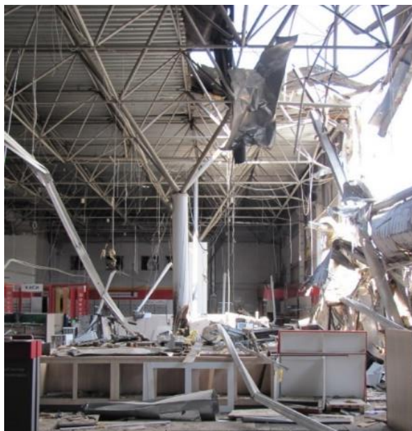
Рис. 2.32 Загальний вигляд пошкоджень центральної колони приміщення
