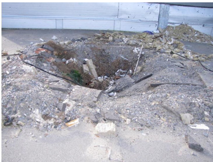
Рис. 2.5. Характер воронки та стану дорожнього покриття після влучання 152 мм осколково-фугасного артилерійського снаряда калібру 152 мм (Північна Салтівка, м. Харків); підривач установлений на сповільнену (фугасну) дію
